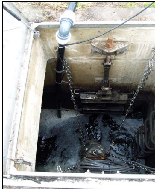
Abbildung 10: Blick in den Ablaufschacht der Nachklärung, mit Rohrleitung als Verbindung zwischen Tauchpumpe (eingetaucht im Wasser) und Lysimeteranlage.
